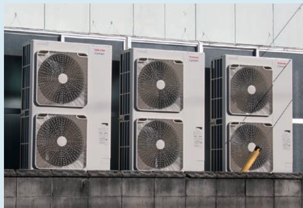
▲パッケージエアコン室外機
