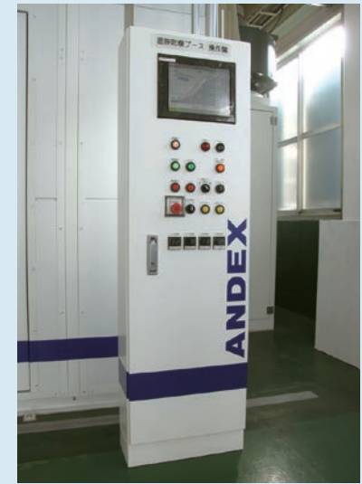
▲塗装ブース制御盤
